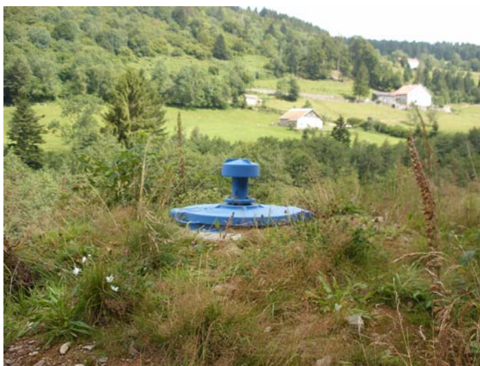
Captage d'eau en Côte-d'Or (photo CD 21)
