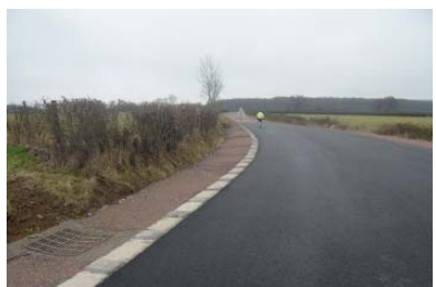
Après travaux Courbe et vibreurs RD 26 sortie de SAINT-THIBAULT après le pont en direction de VITTEAUX
